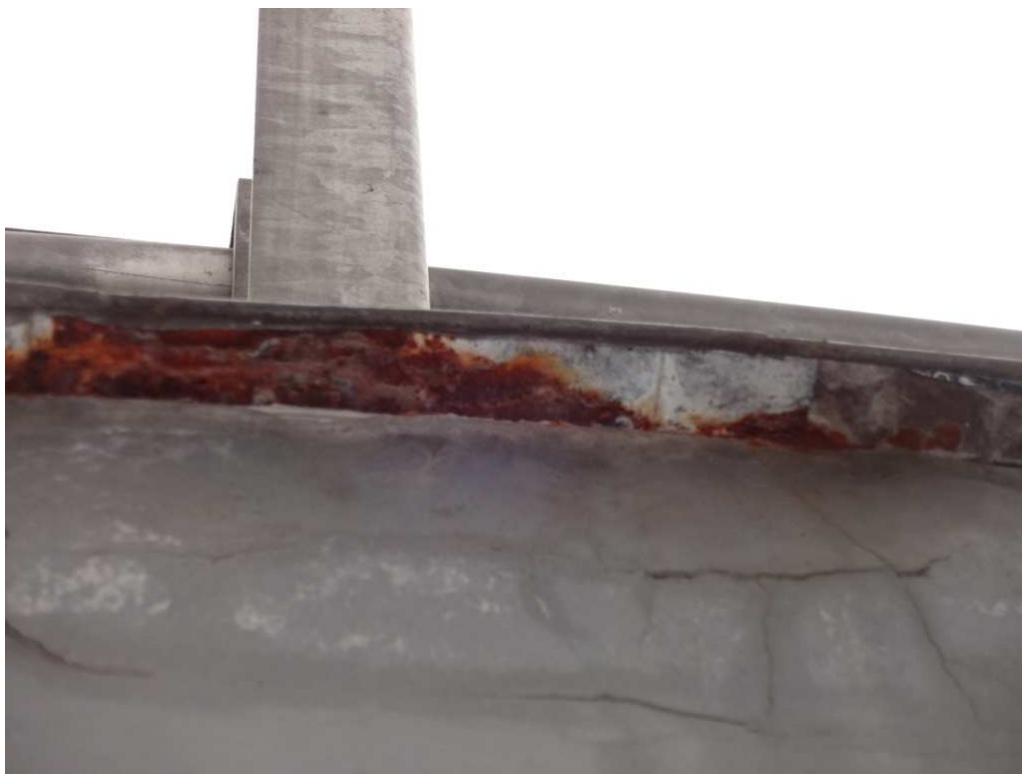
Fot.19. Korozyja obróbek blacharskich w wyniku błędnie wykonanych obróbek blacharskich.
