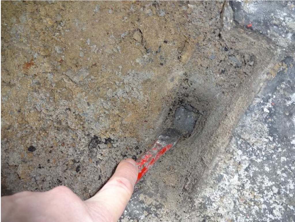
Fot.25. Wilgotny beton pod słabej jakości izolacją z papy.
