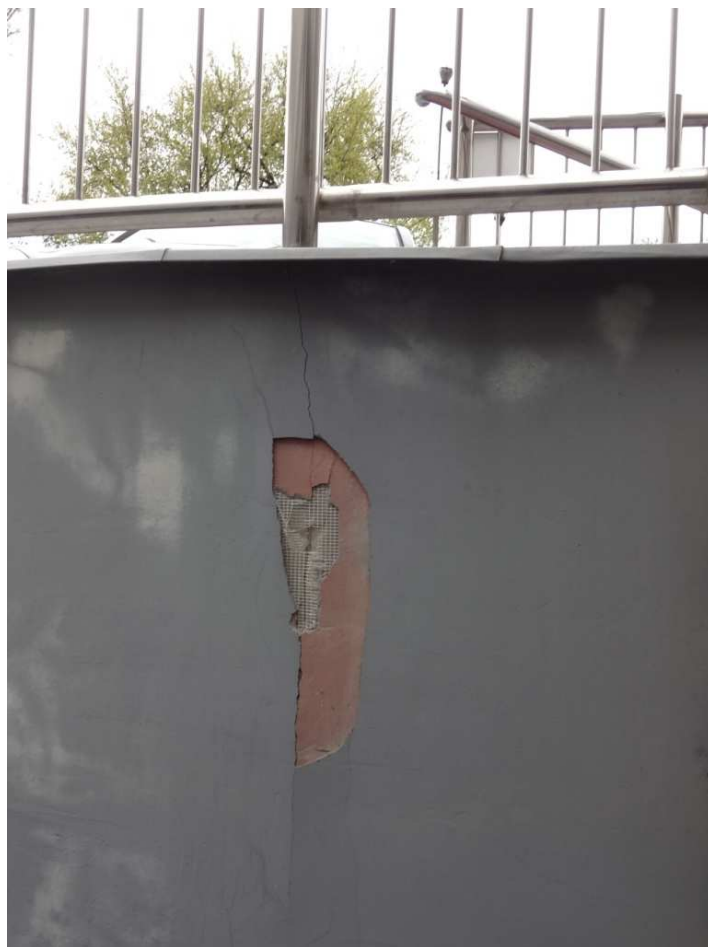
Fot.11. Zarysowanie ściany oporowej.
