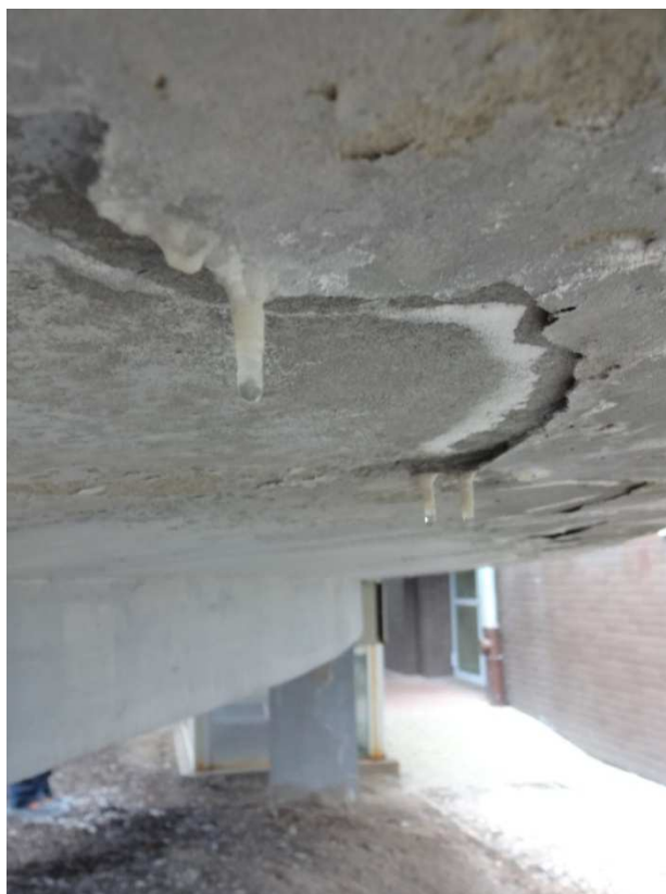
Fot.9. Stalaktyty, białe wykwyty i odspojenia warstwy licowej od spodu płyty rampy dla niepełnosprawnych świadczące o nieszczelności izolacji pod warstwą płytek gresowych.
