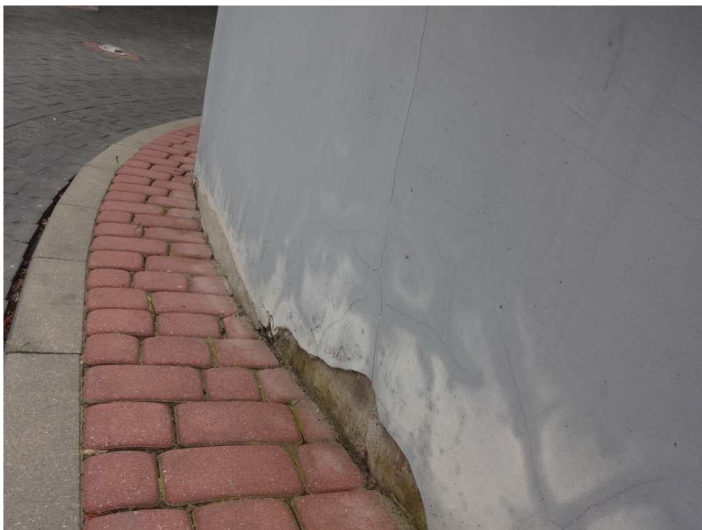
Fot.15. Odspojenia warstwy licowej w wyniku braku izolacji wodochronnej.
