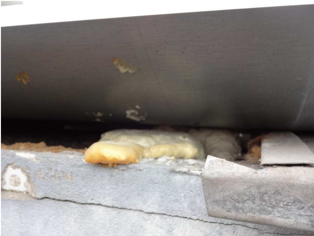
Fot.18. Obróbki blacharskie położone bezpośrednio na podłożu montowane za pośrednictwem pianki poliuretanowej.
