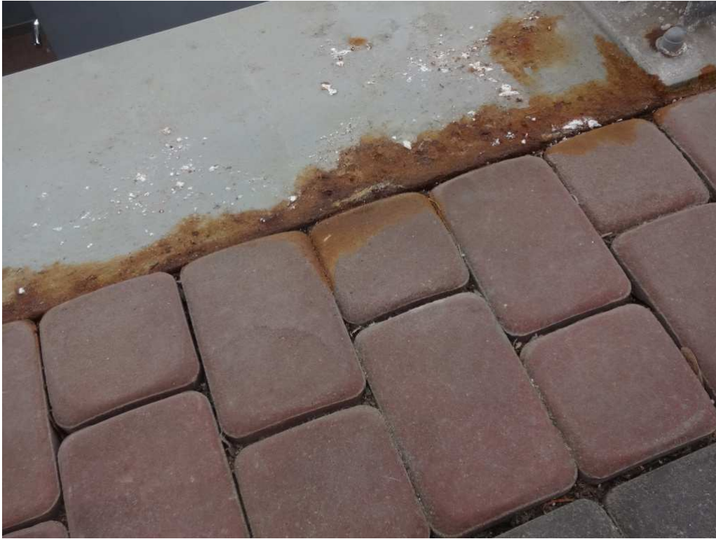
Fot.17. Korozyja obróbek spowodowana bezpośrednim kontaktem stali z betonem oraz wpływem środków odladzających.
