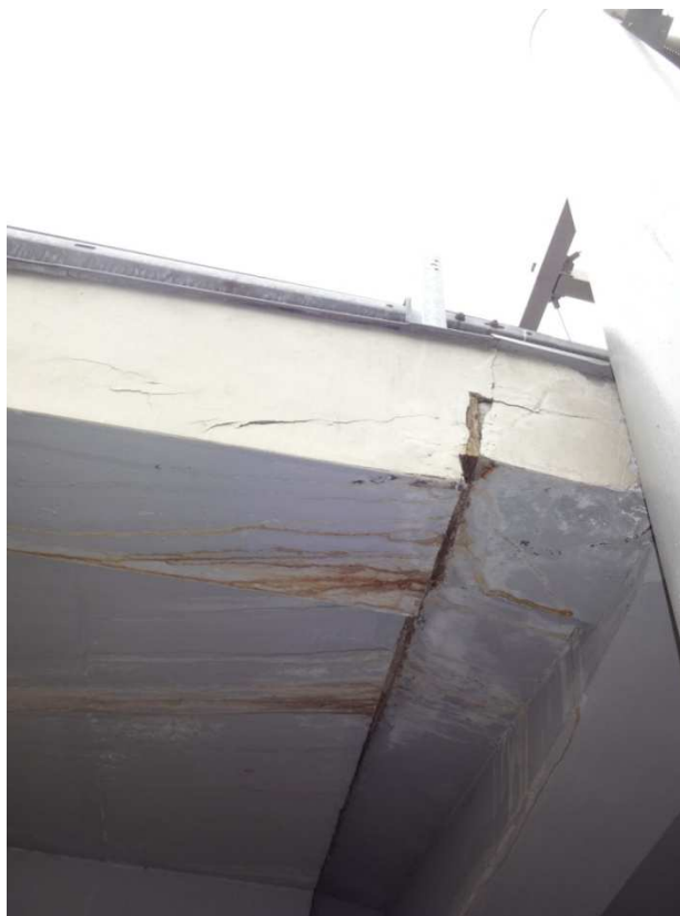
Fot.5. Rdzawe i białe zacieki na spodzie rampy spowodowane nieszczelną dylatacją.
