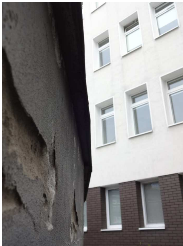
Fot.14. Odspojenia warstwy licowej na rampie zjazdowej.
