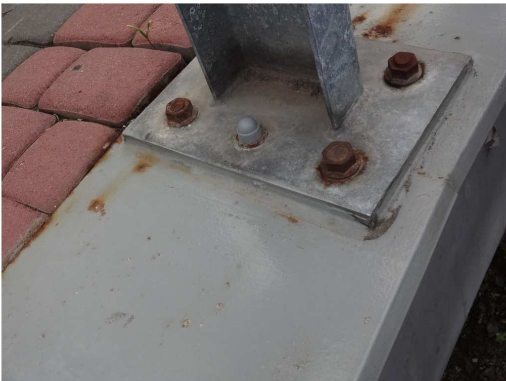
Fot.22. Brak kapturków ochronnych na kotwach.
