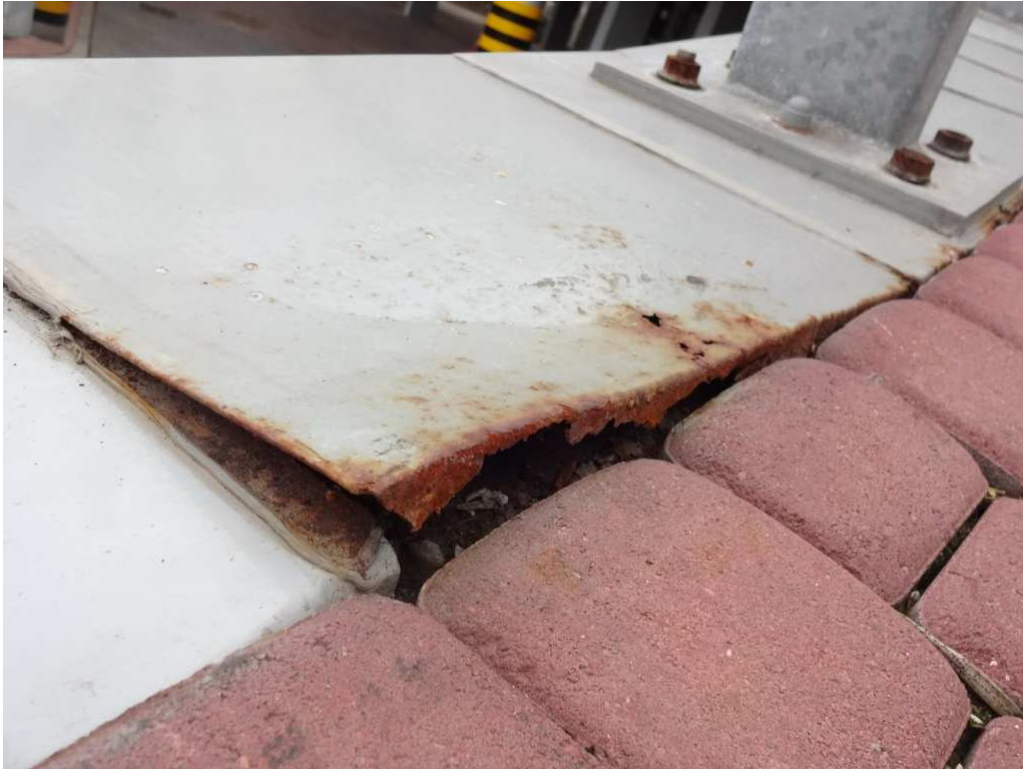
Fot.13. Nieszczelności i korozja obróbek blacharskich umiejscowionych w płaszczyźnie drogi.
