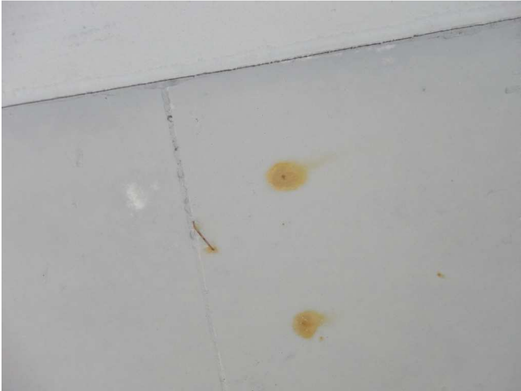
Fot.3. Rdzawe zacieki i wykwyty na spodzie płyty rampy zjazdowej, świadczące o korozji zbrojenia spowodowane brakiem szczelności w warstwie izolacyjnej pod kostką brukową.
