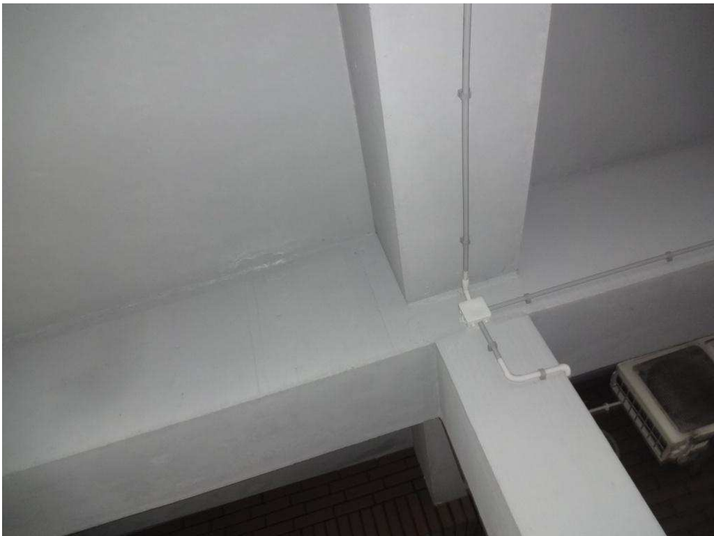
Fot.26. Białe wykwity na spodzie stropu świadczące o nieszczelnościach izolacji z papy.
