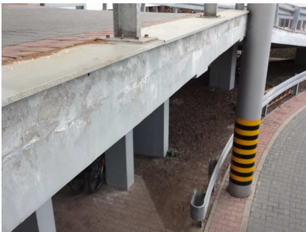
Fot.16. Zawilgocone belki krawędziowe (cokołowe) w wyniku przenikania wilgoci w głąb struktury betonu przez nieszczelną izolacji od strony nawierzchni drogowej oraz obróbki blacharskie.
