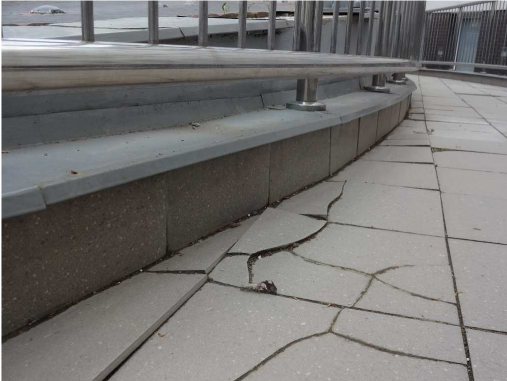
Fot.23. Destrukcje występujące na rampie dla niepełnosprawnych.
