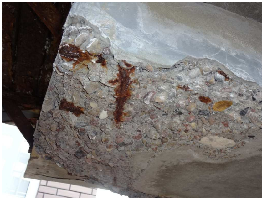
Fot.8. Korozja zbrojenia i niedowibrowany beton oraz brak otuliny na końcu rampy dla niepełnosprawnych.
