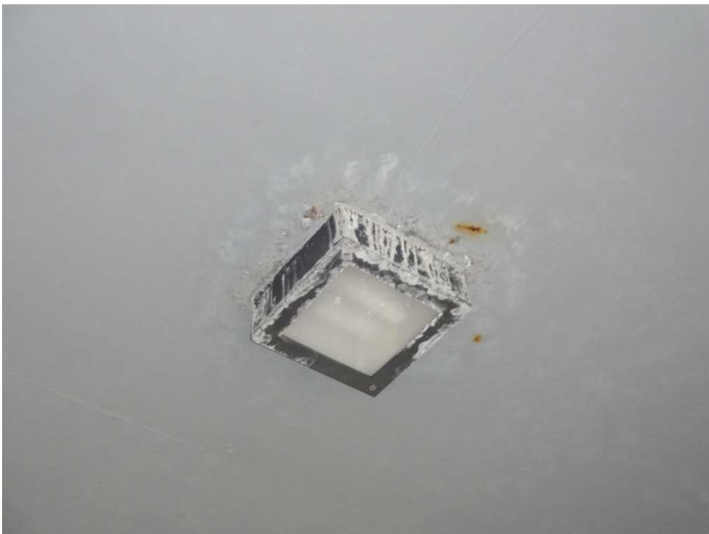
Fot.4. Rdzawe i białe wykwyty (wykwity solne) świadczące o penetracji wilgoci w głąb płyty żelbetowej rampy zjazdowej będące konsekwencją nieszczelności w izolacji pod kostką brukową.
