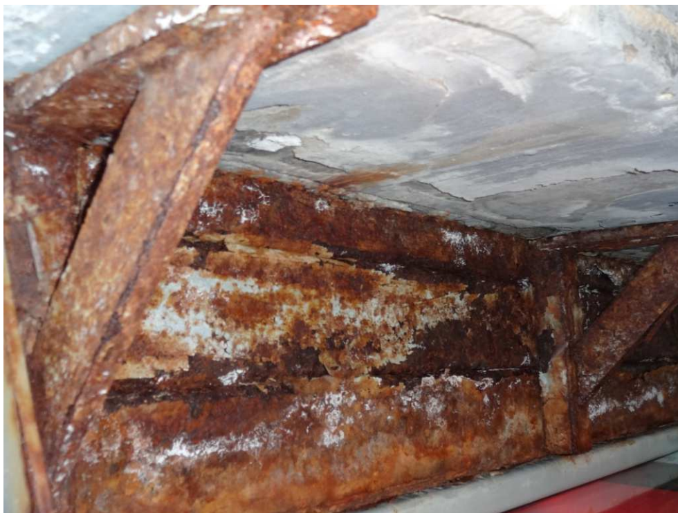
Fot.6. Odpadające płyty zaawansowanej korozji w elementach stalowej konstrukcji (wspornik) przy windzie dla niepełnosprawnych.
