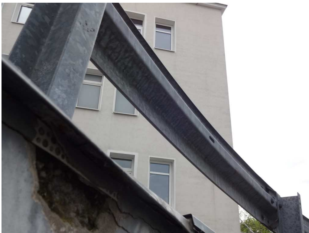
Fot.20. Ubytki w warstwie licowej i betonie spowodowane procesami zamarzania wilgoci, która przedostała się do struktury rampy w wyniku nieszczelności.
